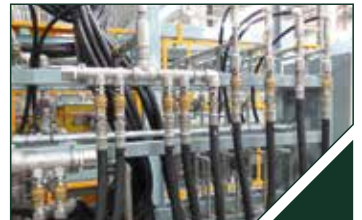
Hidrolik Tesisatlama Instalación hidráulica
